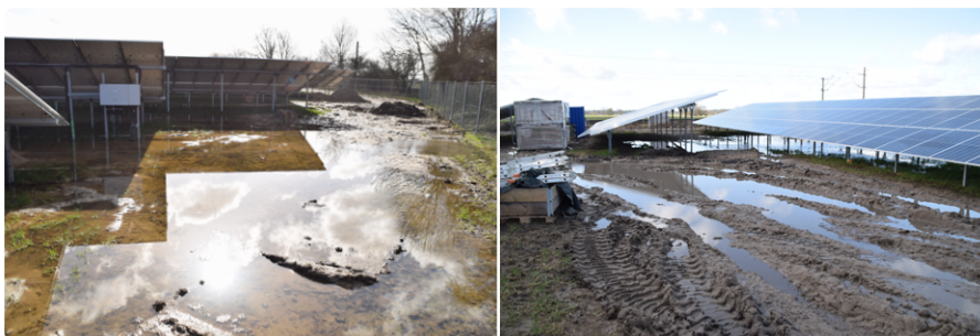
Abb. 1: Eine unzureichende Versickerung von Niederschlagswassern führt zu Bodenschäden und Verzögerungen im Bauprozess. Eine gezielte Ableitung in Kleingewässer ermöglicht die Entwicklung hochwertiger Lebensräume.
