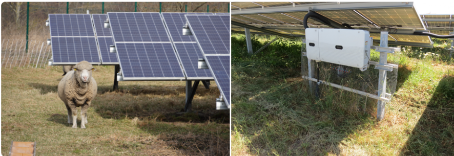
Abb. 23: Beweidung von PV-Anlagen mit Schafen (links) und erforderliche Schutzmaßnahmen an einem Wechselrichter (rechts).
