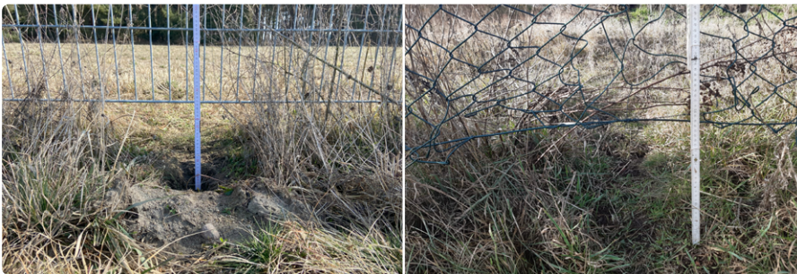
Abb. 3: Bei zu geringem Abstand vom Boden verursachen Wildtiere beim Eindringen Schäden an den Zaunanlagen. Der Durchlass sollte deswegen ausreichend hoch sein (mind. 10 cm).
